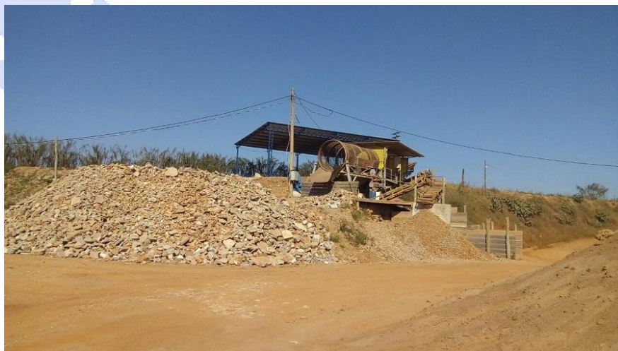
Figura 2 - RCD acondicionado próximo ao britador.
