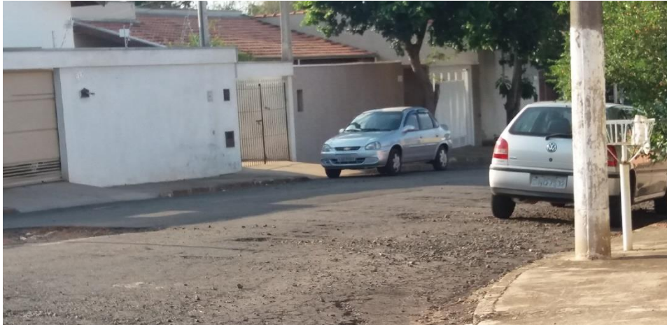
Figura 8: Deterioração do asfalto no Jardim Silvania.
